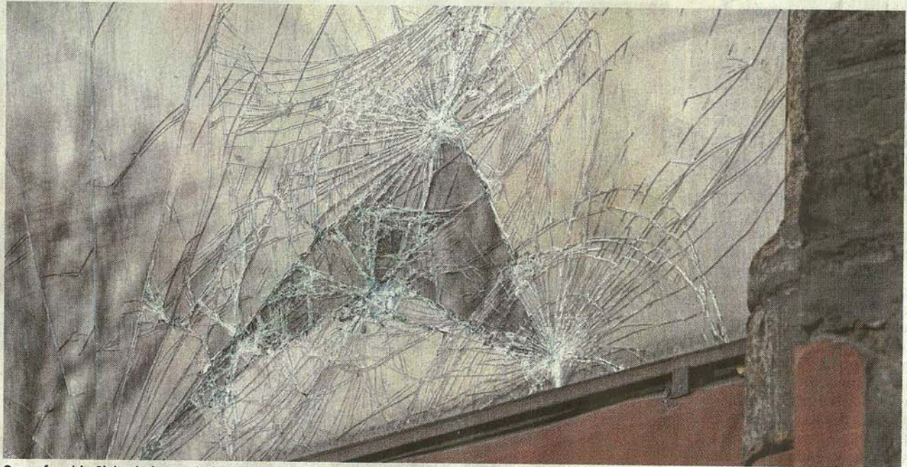
Geworfen, bis Sicherheits- und Kirchenglas brachen: Die Schäden an St. Ewaldi sind unübersehbar.
